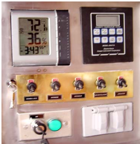
Temp/HR interior y exterior Encendido y control eléctrico
